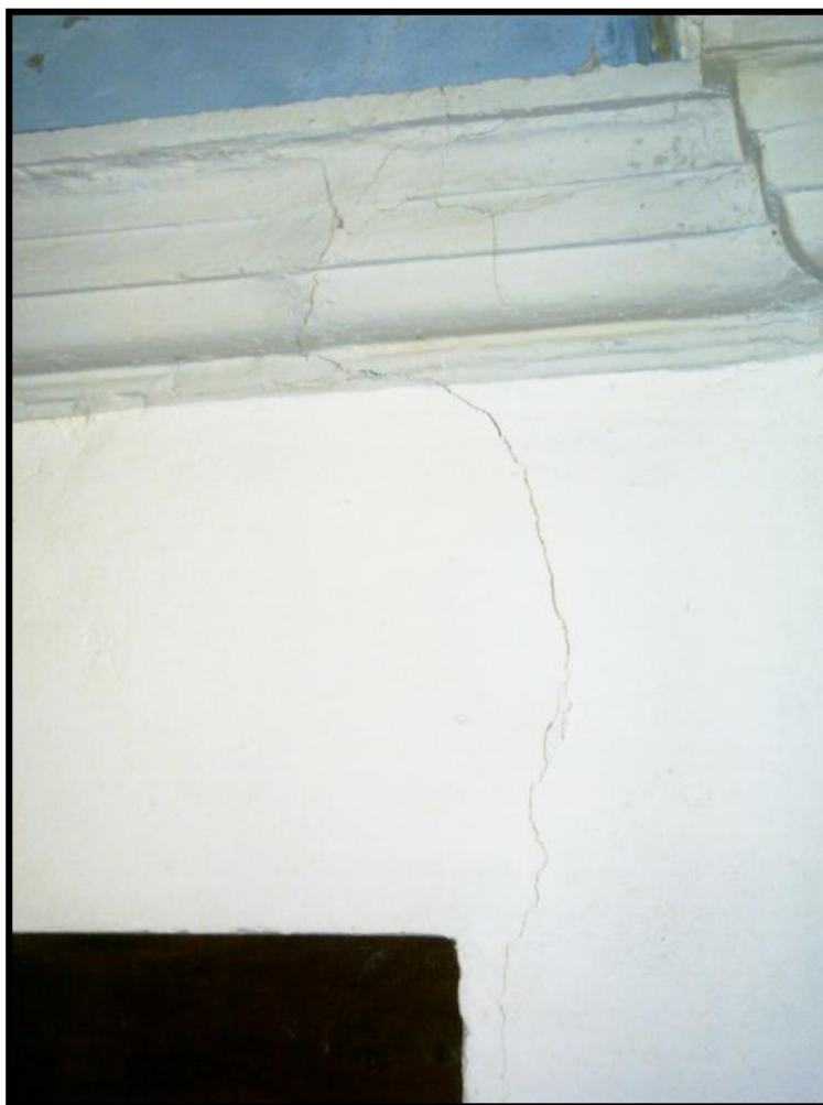
Foto I - Lesione muratura volta abside - lato sinistro
