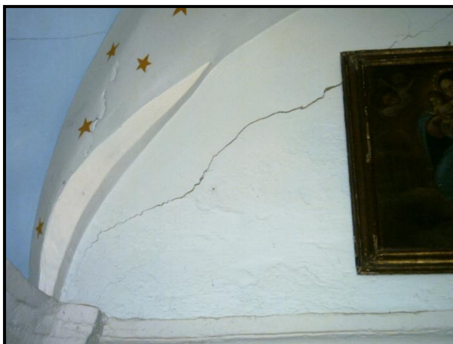
Foto L - Lesione muratura volta abside - lato sinistro
