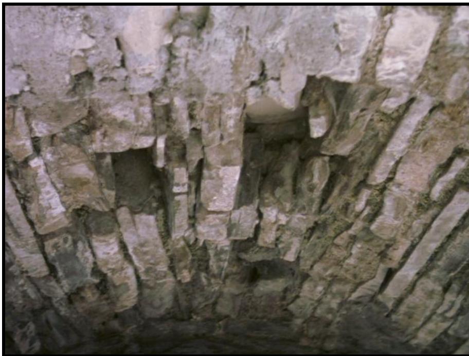
Foto F - Particolare volta solaio campanile
